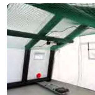
Befestigungsnetz im Dachbereich
