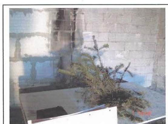
Abbildung 30: nur partielle Schädigung
