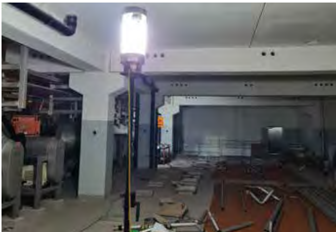
Beleuchtung für Trockenbauarbeiten
