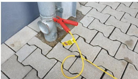
Erdung am Fallrohr
